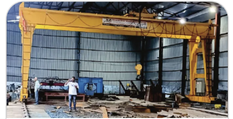
Gantry Crane 15 Metric Ton
